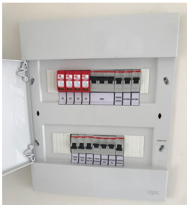
Quadro de disjuntores
